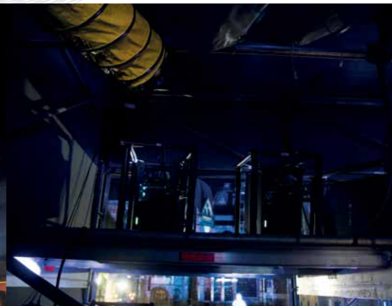
Blick hinter die Kulisse: Zusätzliche Gebläse mussten kurzfristig installiert werden, um 60.000 Watt Heizleistung der Projektoren entgegenzuwirken
